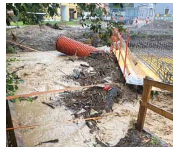
Přivalové deště poškodily stavbu mostu v Kuří. Podle sdělení Krajské právy a údržby silnic přes tyto komplikace zvládnou termín dokončení do konce října 2024 dodržet.
