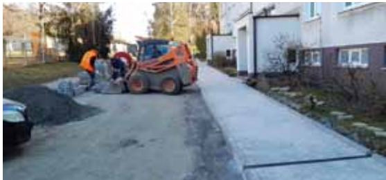
Oprava chodníků Kavčí skála.
